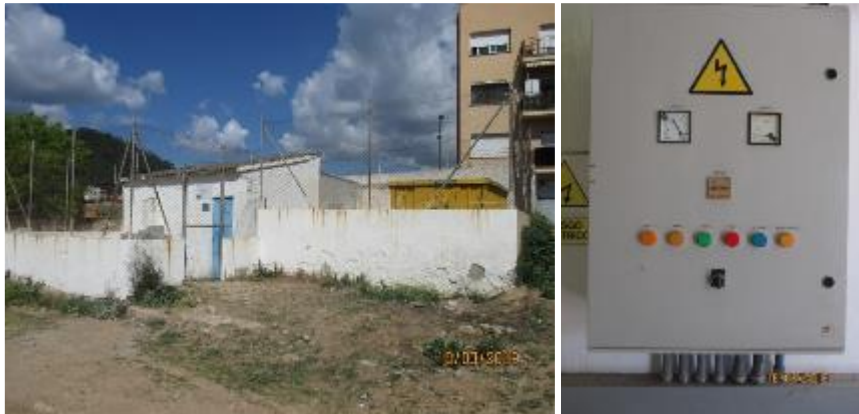
Figura 3. Pou Calderé. Exterior i quadre elèctric
