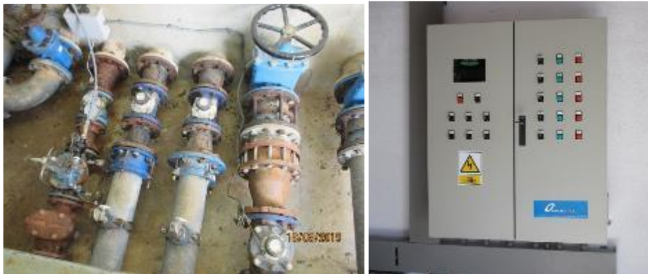
Figura 7. Cambra de claus i telecontrol. Dipòsit La Doma
