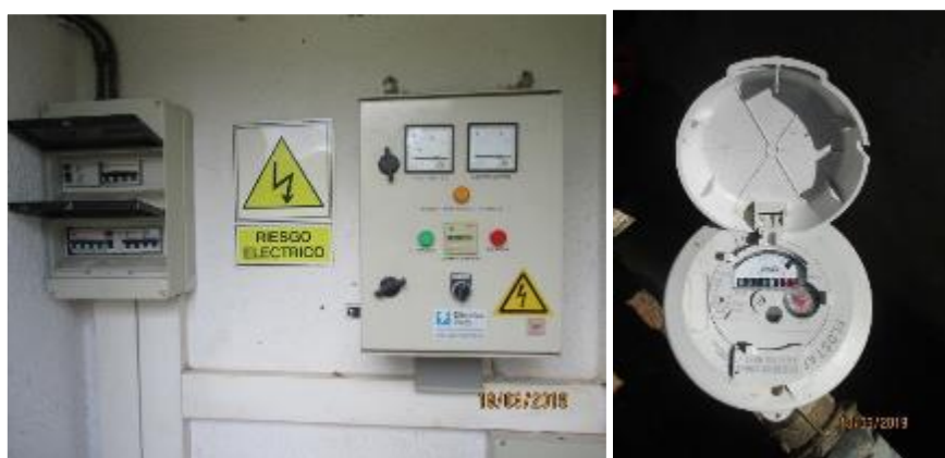
Figura 6. Pou Nou Tremolencs. Quadre elèctric i comptador
