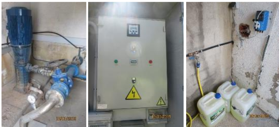
Figura 10. Bombeig, telecontrol i cloració dipòsit Plaça de les Aigües
