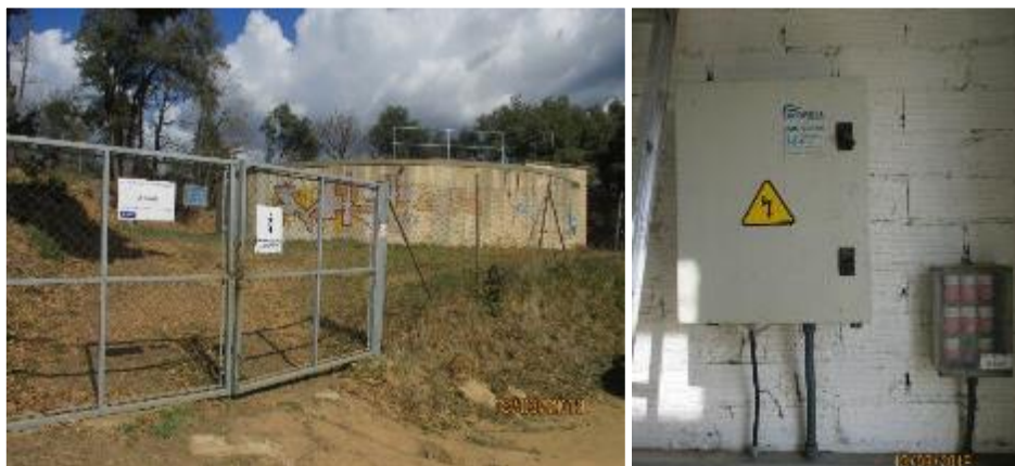
Figura 11. Exterior i telecontrol. Dipòsit Tremolencs 2
