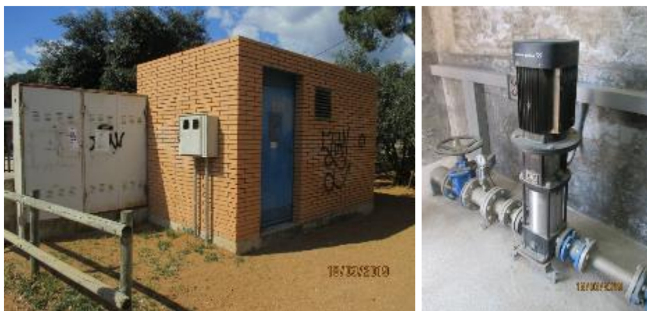
Figura 16. Exterior i bomba. Estació Elevadora Alpe
