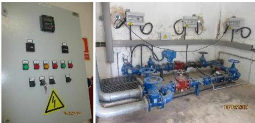
Figura 13. Quadre elèctric del bombeig i telecontrol. Dipòsit Can Tomàs
