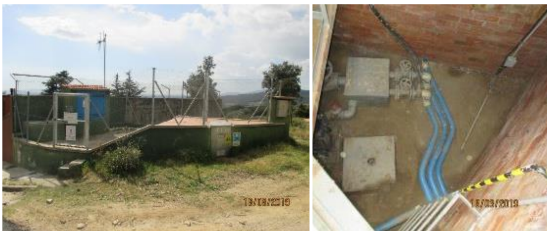
Figura 15. Exterior i bombeig dipòsit Can Poi 50
