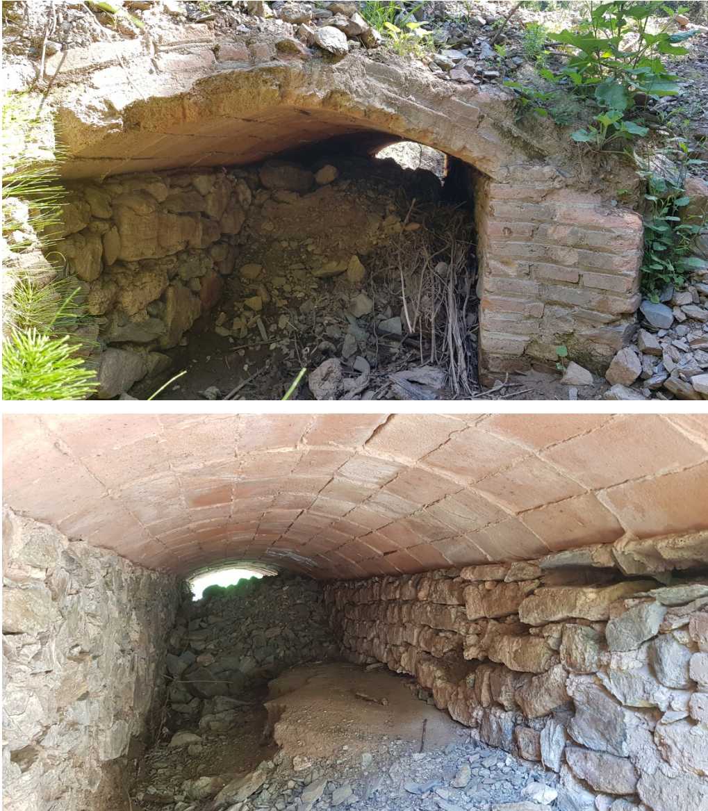
Imatge 4. Acumulació de sediments sota el pont
