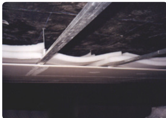
Techo aislante con PKB-2.
