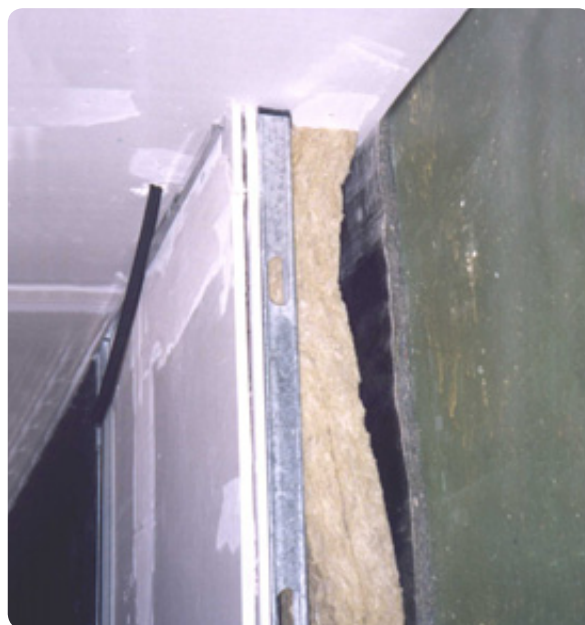
Trasdosado aislante con PKB-2.
